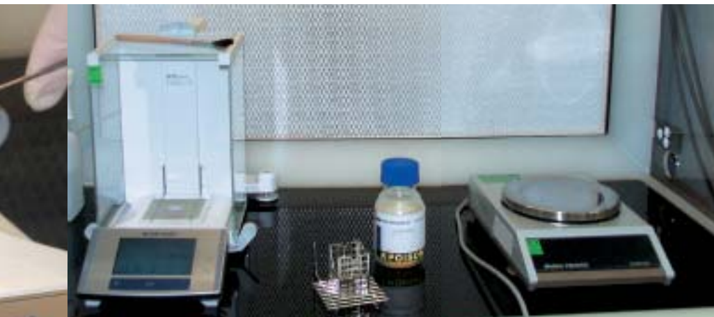
L'ensemble du poste de pesage est installé sur une paillasse de sécurité qui protège le personnel contre les contaminations.
