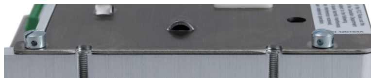
Figura 2-67: Parafusos de Lacre Instalados
